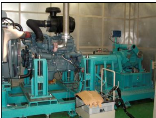
エンジンマウント、移動式共通架台
