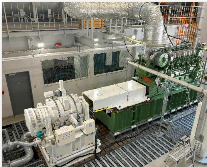
水素エンジンベンチ（水動力計等を納入）
